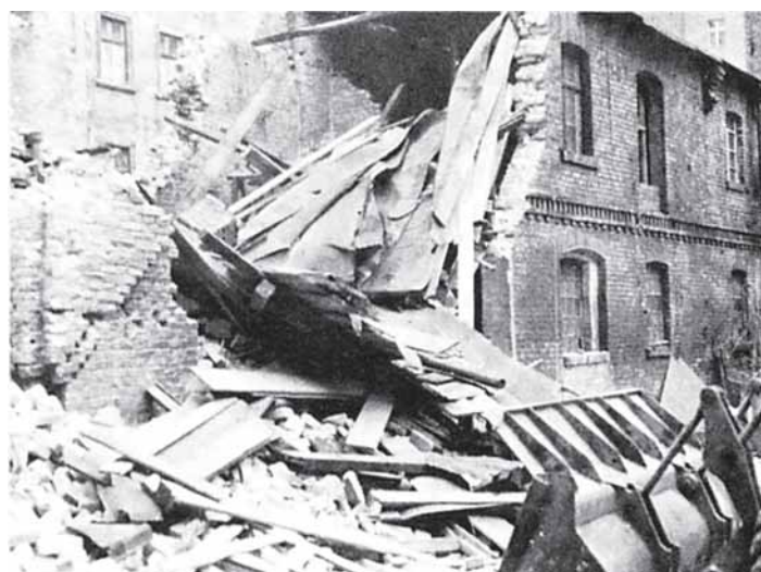
Cuvrystr. 26-27 ungenehmigter Abriss der Remise durch Spekulanten (1980)
